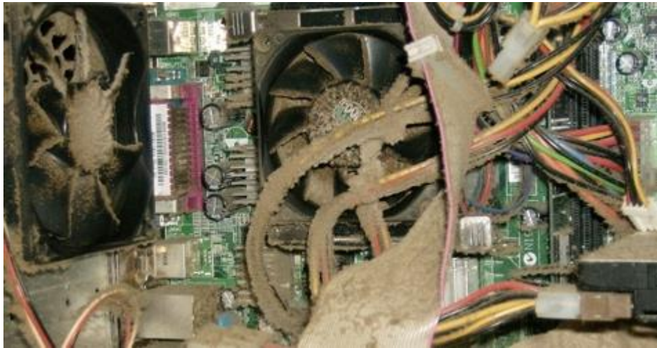
Fig 7 - Cabos e fios com poeira no interior do PC
